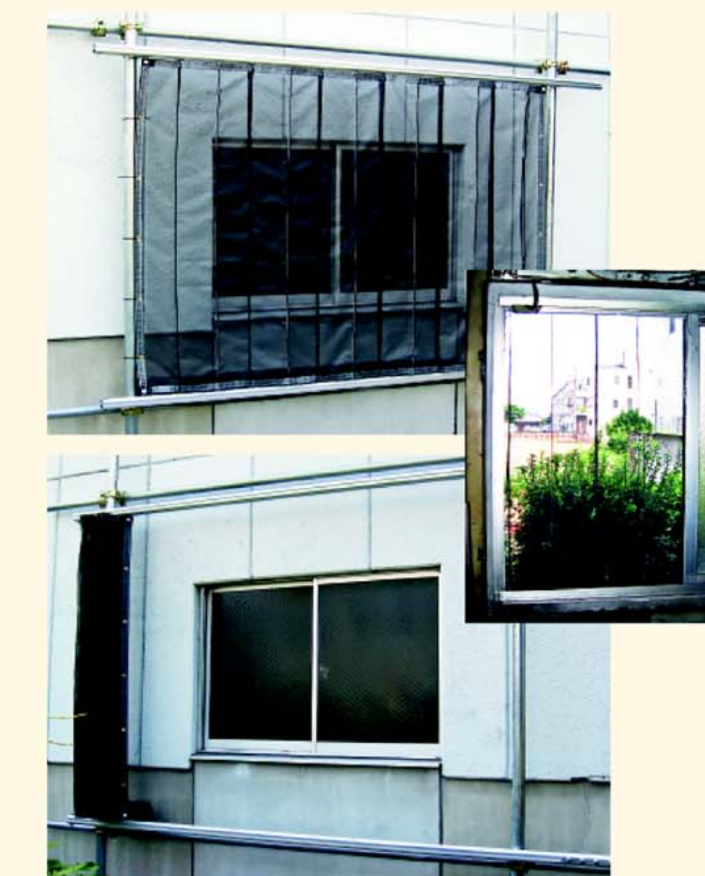
■ 外壁窓 レールに防雪シート (特許申請中)
